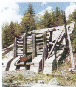
Tramoggia per il carico dei vagoncini della teleferica verso l'impianto di Mezzavalle
